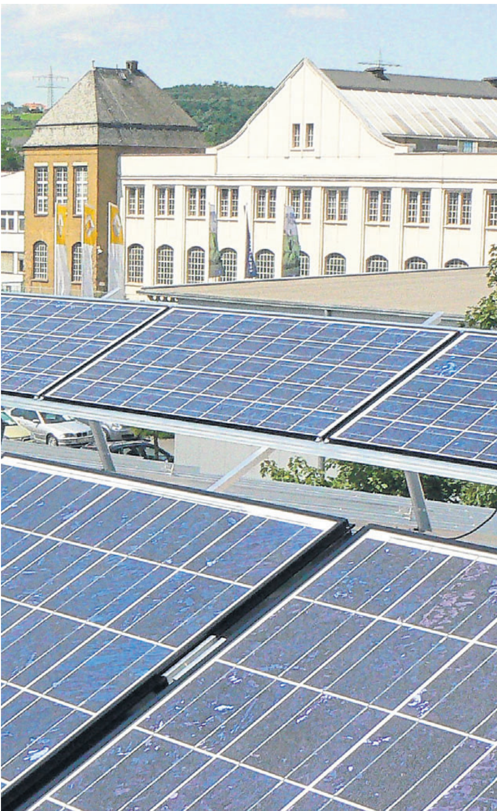
Eine der größten Photovoltaikanlagen im Rheingau steht auf dem Dach des Weinguts Näßler in Geisenheim. Archivfoto: RMB/Heinz Margielsky
